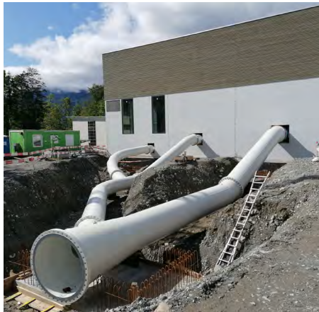
Verteilleitung vor der Kraftwerkszentrale
