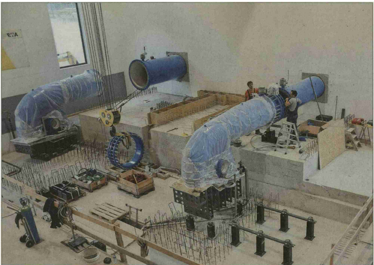
In der Kraftwerkzentrale auf dem Ruag-Areal läuft der Einbau der Maschinen und der Elektrotechnik auf Hochtouren.
