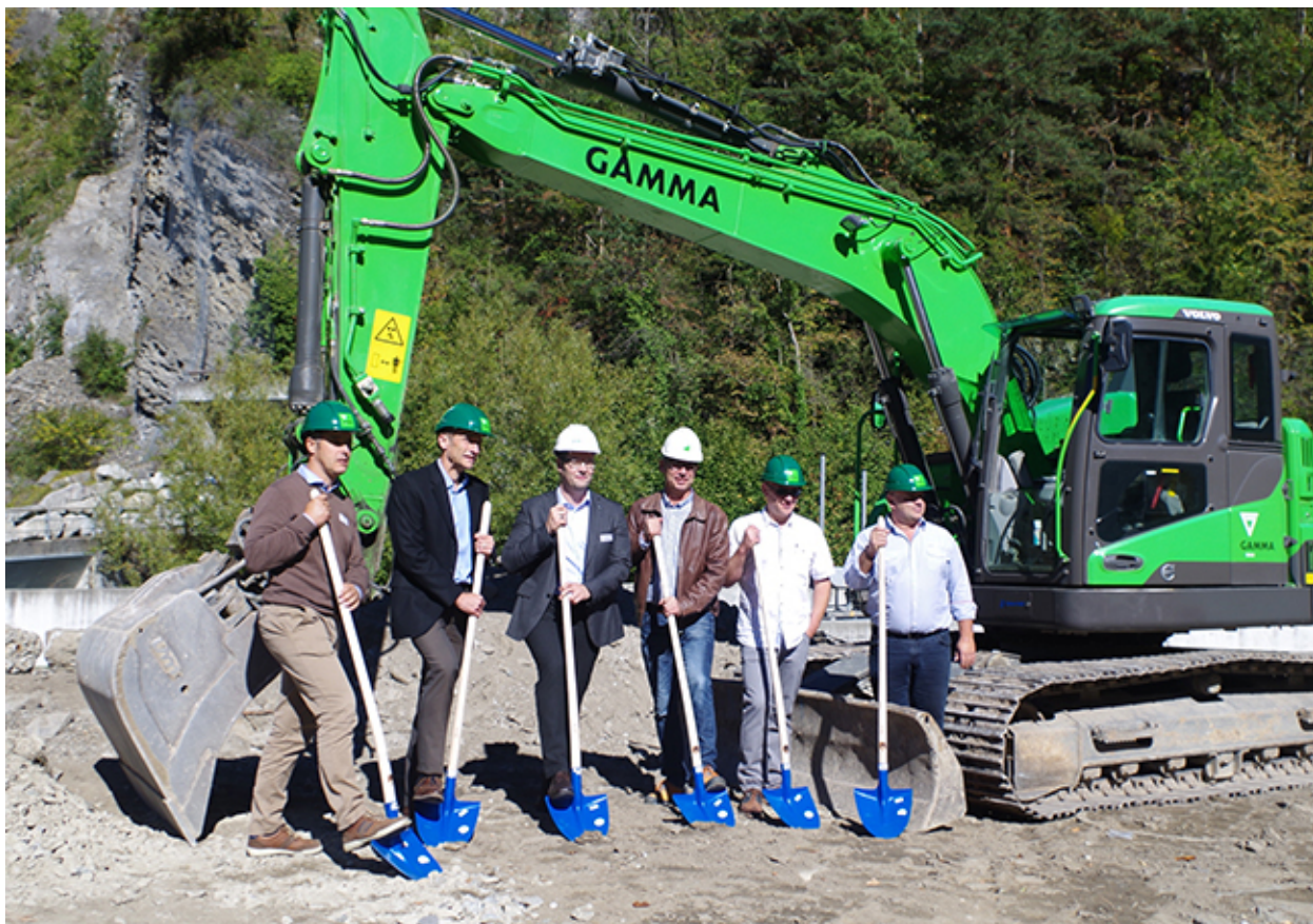
Spatenstich für das Kraftwerk Schächen: v.l. Kurt Schuler, Rolf Müller, Werner Jauch, Odilo Gamma, Georges Schelbert, Leo Baumann
